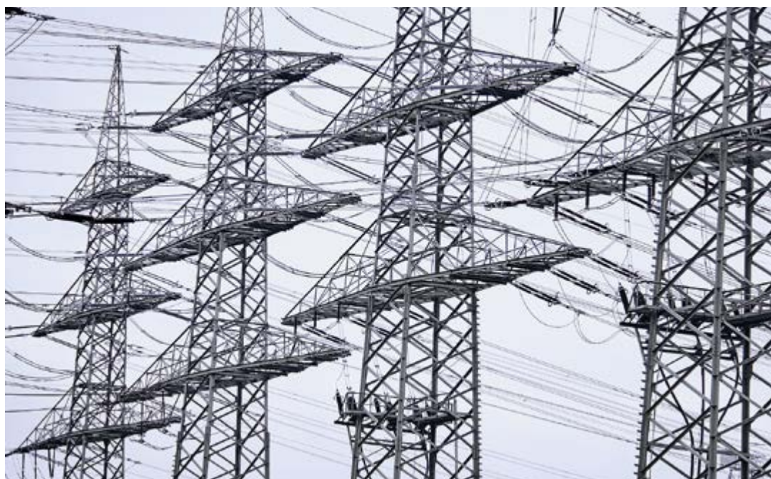
Ohne Strom geht nichts: Doch, woher kommt er? Die Weiterbildung gibt Antworten. Foto: Swissgrid AG.
